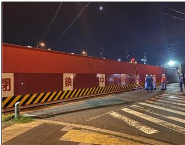
大宮陸閘の全閉状況
